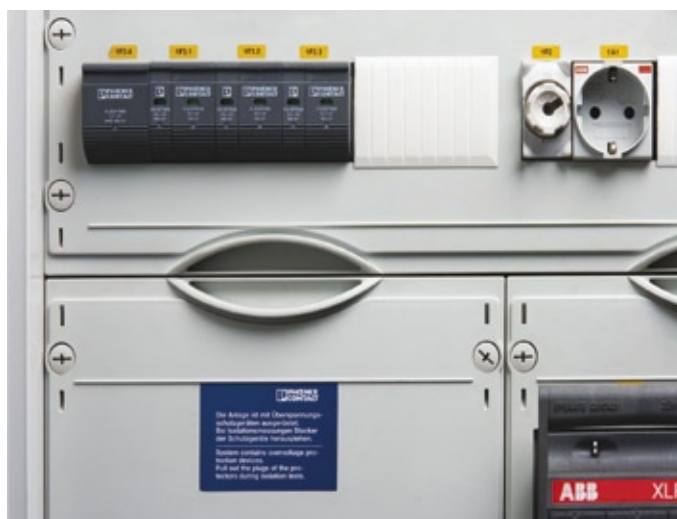
Die in der Unterverteilung installierte Überspannungsschutzkombination (Typ I + II), „Flashtrab compact“, verhindert, dass Blitzströme in die Elektroinstallation eindringen
