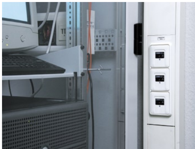
Der Überspannungsschutz der Stromversorgung am LAN-Verteiler hält Störspannungen von den EDV-Geräten fern
