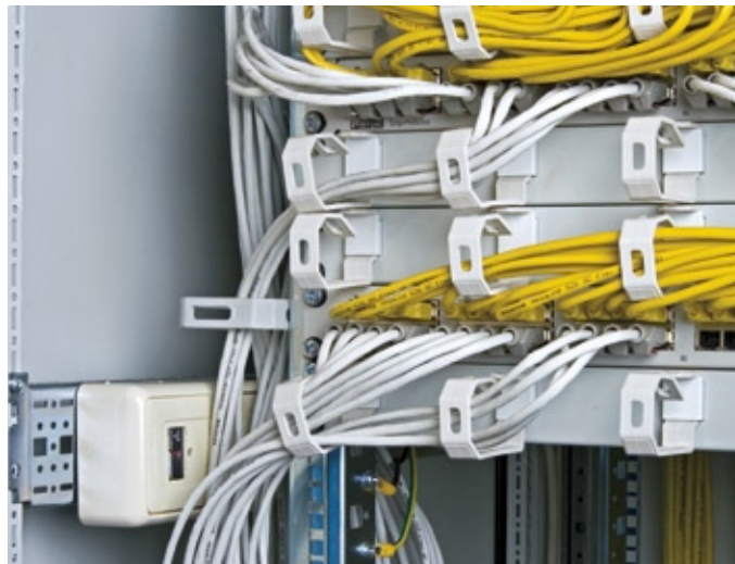
Der Überspannungsschutz der Datenleitungen am LAN-Verteiler sorgt für die unge störte Datenübertragung aller EDV-Anschlüsse
