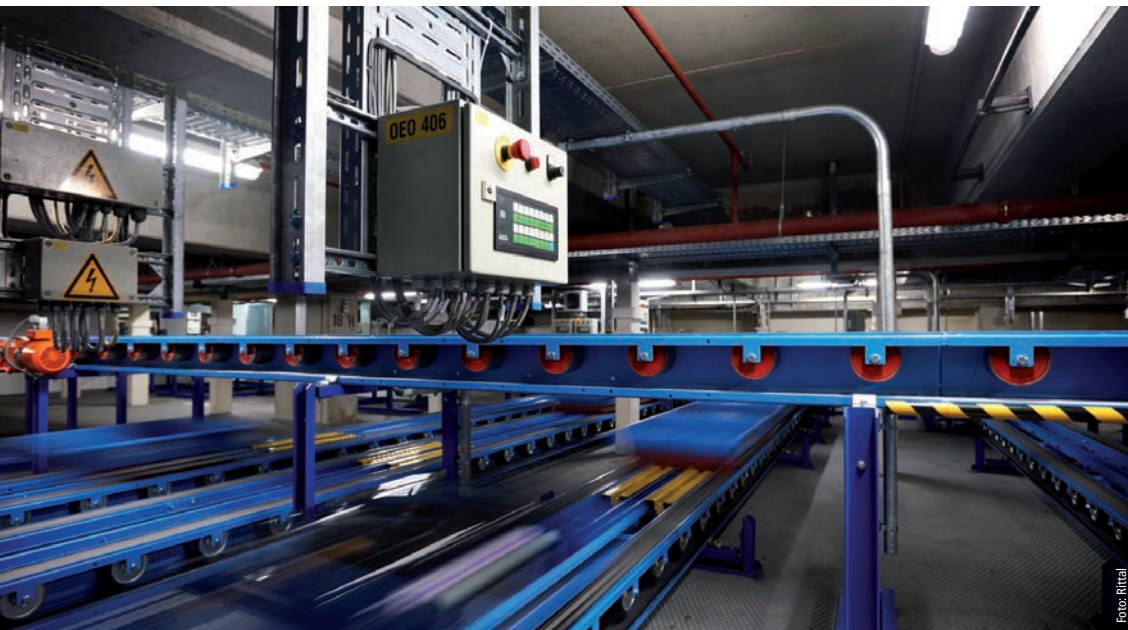
Zum Schutz der Steuerungs- und Stromverteilungstechnik in der Gepäckförderanlage sind über 500 Gehäuse der Serie CM und AE sowie über 100 TS 8 Schaltschränke und Kühlgeräte von Rittal installiert.
