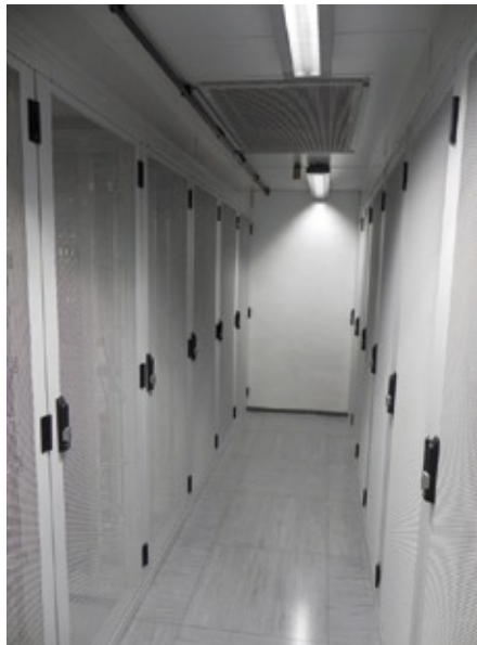
Blick ins neue Rechenzentrum
