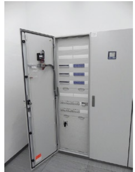
Verbrauchsabrechnung erfolgt mittels exakter Messung
