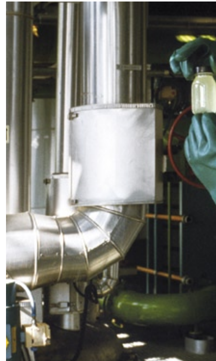
PSA im Industriebetrieb.
