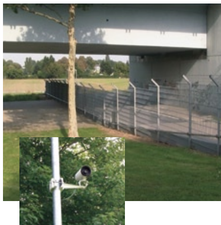
Diese Wärmebildkameras von FLIR überwachen einen der durch Hochwasser bedrohten Bereiche. Sie kommen ohne jegliche Beleuchtung aus und können dank ihrer großen Reichweite den gesamten Bereich aus sicherer Entfernung überwachen.
