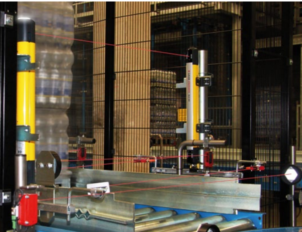
▲ Sicherheit mit kostenoptimaler Sensorik an der Schnittstelle zwischen Rollenbahn und Drehtisch.
