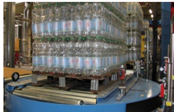
▲ Sensorik für die Steuerung der Drehbewegung.
