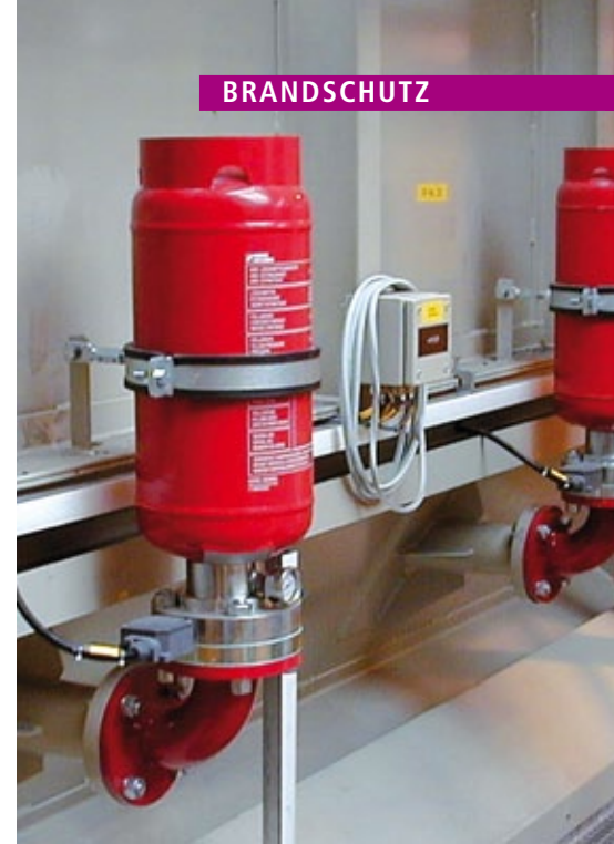
▲ HRD-Löschmittelbehälter mit speziellem KiDDeX-Löschpulver zur Explosionsunterdrückung an einem Entstaubungsfilter
