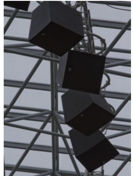
Im Olympiastadion (NSK) bilden Lautsprecher der Serie EV-Innovations, Endstufen EV CPS und Digital Matrix Controller EV N8000 die Kernstücke der Beschallungsanlage.
