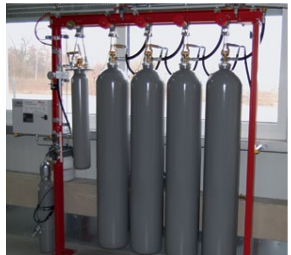
▲ Eine CO 2 Löschanlage schützt die Produktion bei Folex in Köln
