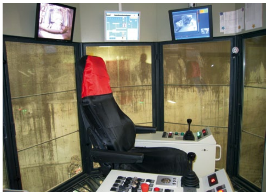
▲ Müllbunker-Krankanzel: Blick in den Führerstand
