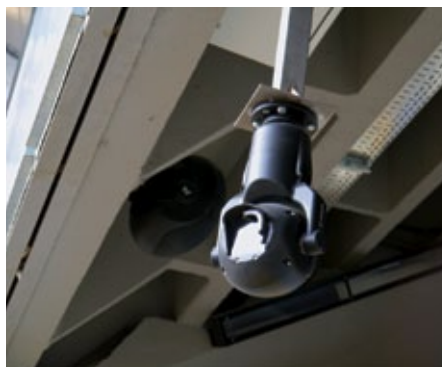
Vandalensichere MIC-400-Kameras in Edelstahl-ausführung wurden im Fanbereich installiert.
