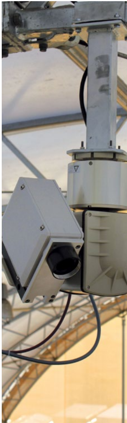
Zur stationären Überwachung der ehemaligen Sondermülldeponie Kölliken kommen zwölf hochauflösende Wärmebildkameras mit Schwenk-Neigekopf zum Einsatz
