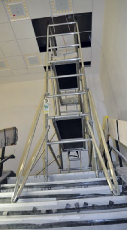
Die Prüfung von schwer zugänglichen Brandmeldern ist oft zeitintensiv und stört den Betriebsablauf. Zusätzlich können Kosten für Hilfswerkzeuge oder zusätzliches Personal entstehen
