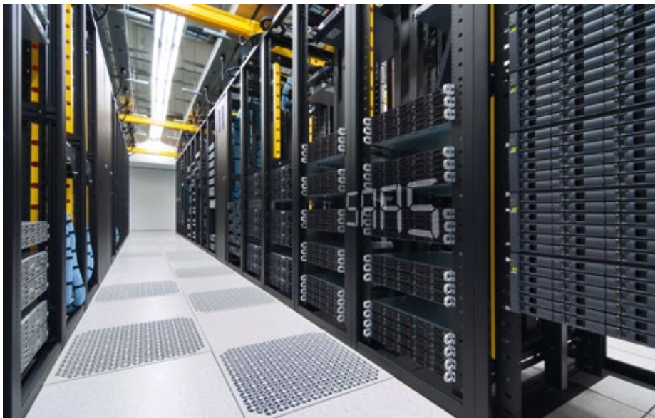
Software as a Service im Isgus eigenen Rechenzentrum
