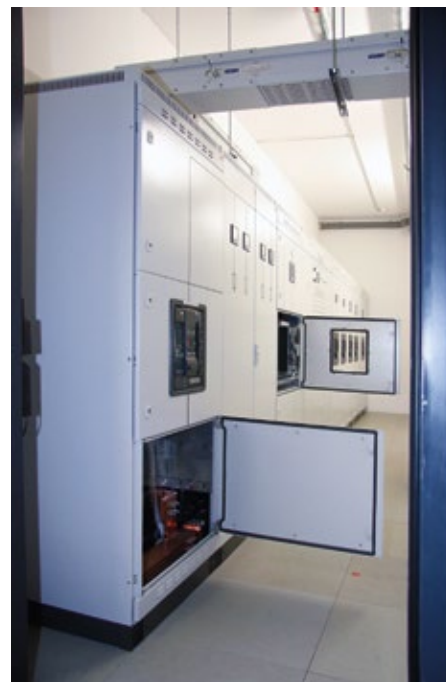
Die Niederspannungshauptversorgung (NSHV) hat einen Bemessungsstrom von 4.000 Ampere und basiert auf dem Rittal Ri4Power-System
