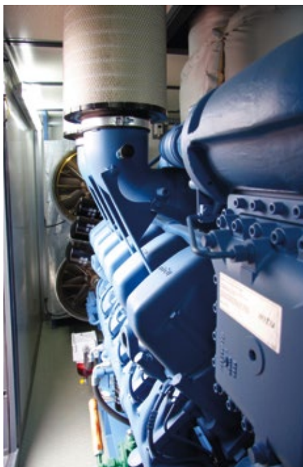
Fällt in Hannover der Strom aus, stellt das Diesellaggregat die Stromversorgung des Rechenzentrums für 72 Stunden sicher
