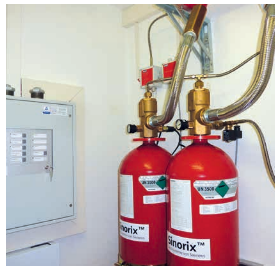
Seit 2006 ist der Serverraum des Krankenhauses mit einer Sinorix Novec Gaslöschanlage von Siemens ausgestattet
