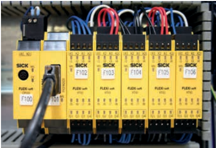
Die Flexi Soft-Systemkonfiguration bei Humard besteht aus dem zentralen CPU-Modul, fünf XTIO-Ausgangs-Erweiterungsbausteinen sowie dem Drive Monitor
