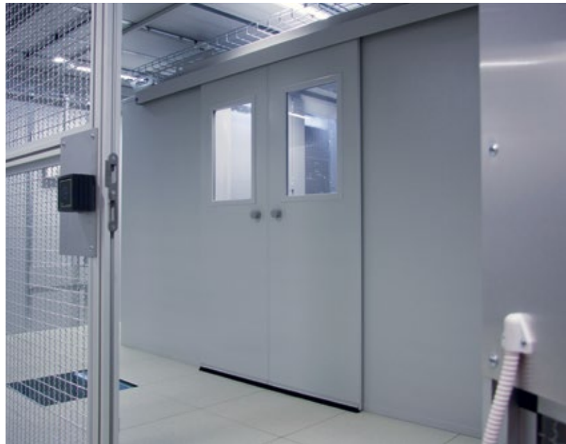
Das Rechenzentrum aus dem Hause Rittal stützt das einzigartige Logistikkonzept der Firma Remmers
