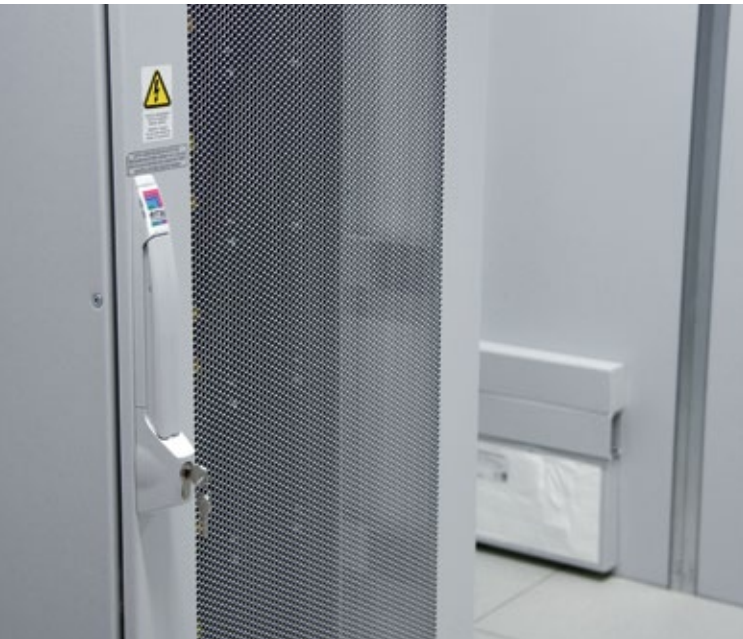
In den Technikräumen genügt ein Grundschutz, während der Server-Raum über eine höhere Sicherheitsstufe für höchste physikalische Sicherheit verfügt
