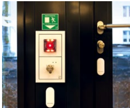
Beispiel für eine Fluchttürsteuerung mit Notentriegelung und elektronischem Schließzylinder (zur Freischaltung) in der Kantine
