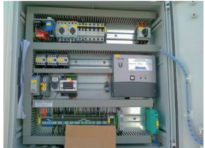
Alle Container sind mit Schaltschränken ausgerüstet
