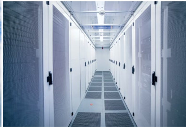
Das Datacenter hat eine Gesamtleistung von 5,2 MW und ist mit modernster Gaslöschtechnik und einer Sauerstoffreduzierungsanlage ausgestattet
