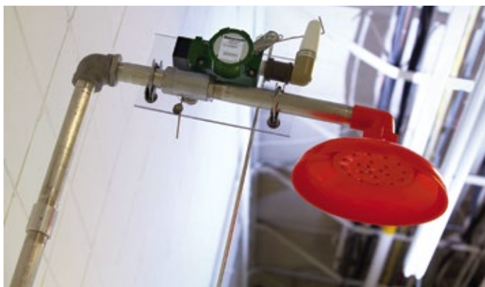
Notfalldusche mit Limitless-Schalter von von Honeywell
