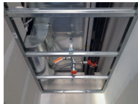
Flexibles Sprinkler-Formteilsystem an überfüllter Decke
