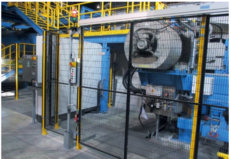
Der Zutritt zur Anlage erfolgt durch eine der über 50 Türen
