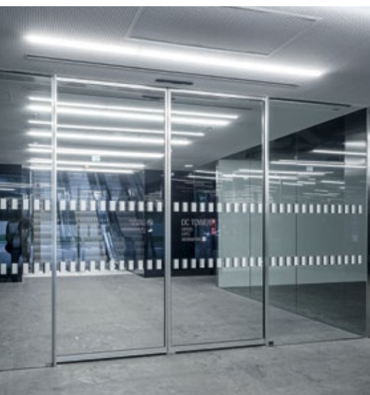
Automatische Türsysteme mit Slimdrive SL NT-Antrieben im DC Tower 1: die Antriebe sind nur sieben Zentimeter hoch und ideal für feingerahmte Türprofile
