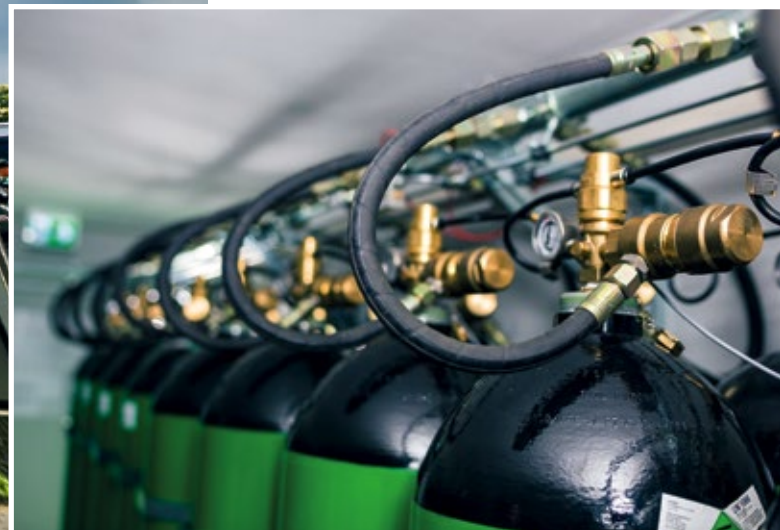
Das für die Löschung benötigte Inertgas Stickstoff wird in Flaschenbatterien gelagert und mittels einer Vorrichtung zur Softflutung in den Schutzraum eingebracht
