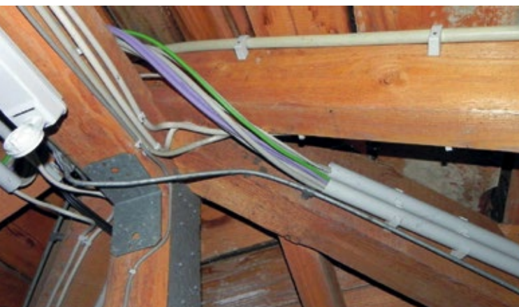
Nicht eingehaltener Trennungsabstand von Leitungen zu Blitzableiter
