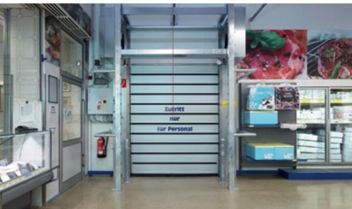
Hermetischer Temperaturabschluss zum Tiefkühlbereich
