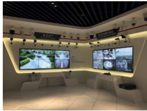
Der Showroom zeigt den aktuellen Stand der Technik in der Videoüberwachung
