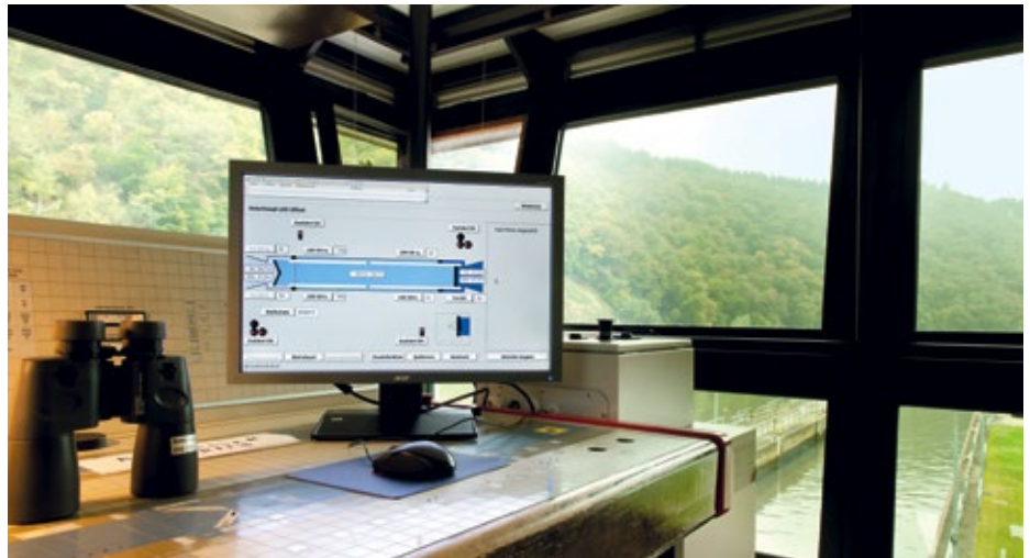
Visualisierung eines der Schleusenvorgänge im Schleusenturm. Das Fernglas wird demnächst durch Kameras ersetzt
