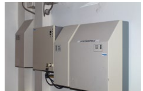
Die Siemens MK2-Controller erhielten ein Update der Controller-Firmware
