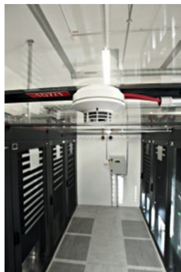
In den Kaltgängen mit den Racks kommen in Zweimeldungsabhängigkeit Typ B geschaltete punktförmige Mehrfachsensormelder MTD 533X zum Einsatz
