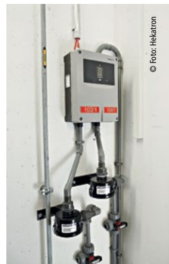
Den Doppelboden unter dem EDV-Raum sichert ein Ansaugrauchmelder ASD 535-2 von Hekatron
