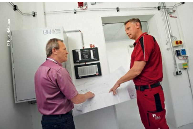
Planer Erwin Knosp und Errichter Ilija Divkovic besprechen vor der Brandmelderlöschzentrale Integral IP MXF/MXE Details der Brandschutzlösung
