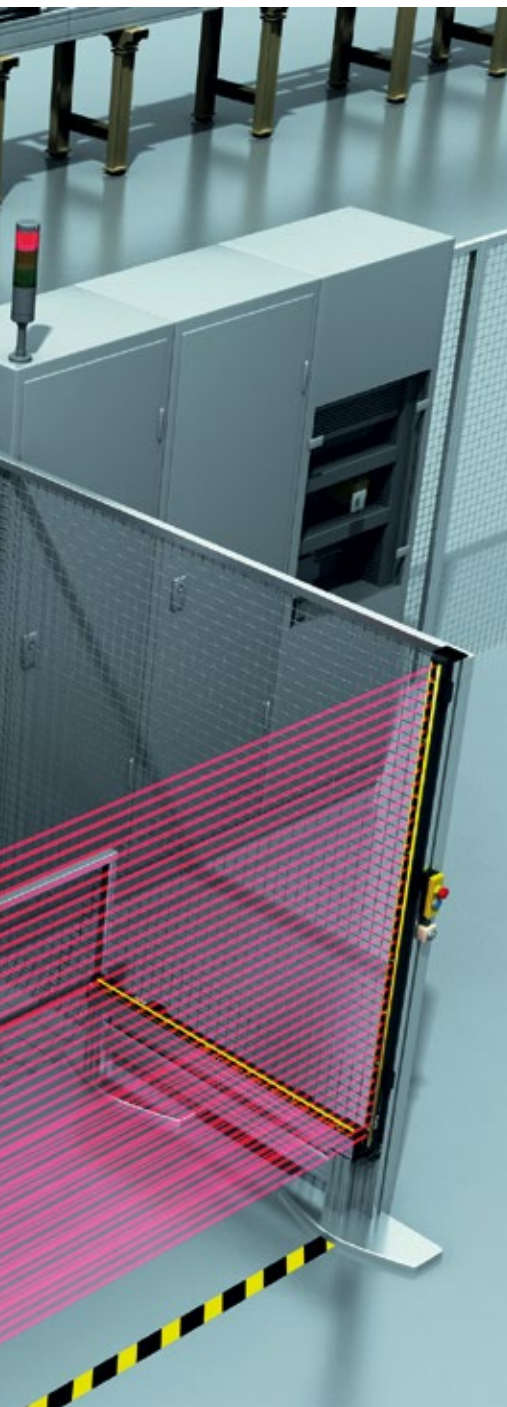
▲ Eine Arbeitssituation, in der sich Mensch und Maschine bei der Interaktion zeitgleich in benachbarten Bereichen aufhalten, wird als Koexistenz bezeichnet. Ein typisches Beispiel hierfür ist eine Einlegestation mit Drehtisch an einer Roboterzelle.
