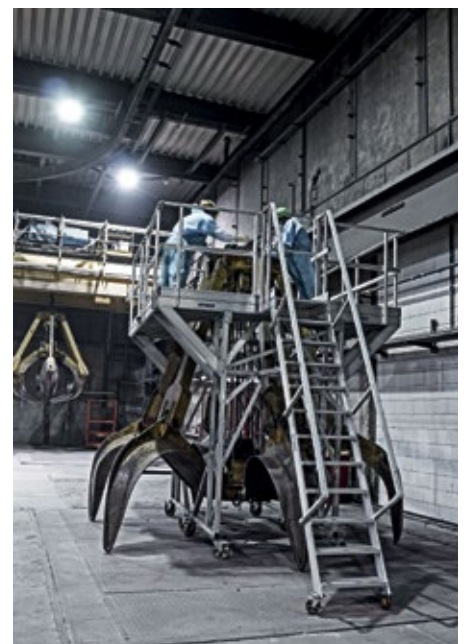
... oder diese zweiteilige Arbeitsbühne zur Wartung der Müllgreifer in einer Müllverbrennungsanlage.
