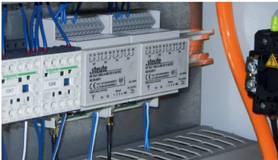
Die Empfangs- und Auswerteeinheiten der beiden Funkfußschalter sind im Schaltschrank untergebracht
