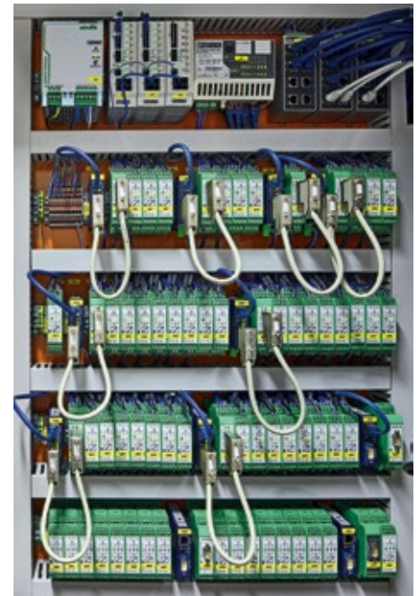
Elektroschaltschrank für die Gebäudeleittechnik im Klinikum – mit Stromversorgung Quint-Power (oben links) und einstellbaren mehrkanaligen Geräteschutzschaltern CBM (rechts davon) sowie Switches und Schnittstellenumsetzern
