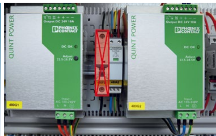
Sicherungen bereits integriert – mit dem neuen Geräteschutz Typ 3 (Bildmitte) kann auf einen separaten Überstromschutz (rot) für den Ableiter verzichtet werden
