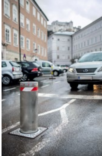
Die mit MCS gesicherten Poller sorgen dafür, dass nur noch Berechtigte Zufahrt haben
