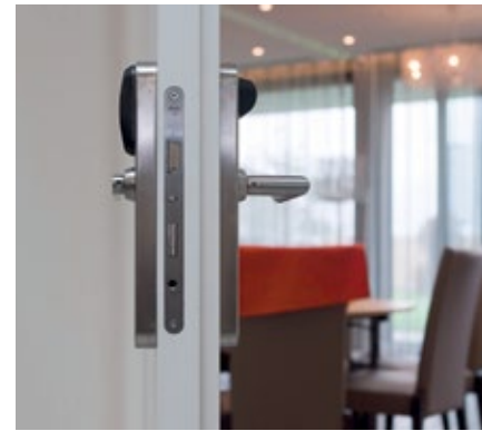
Elektronischer XS4 Original-Wireless-Beschlag an einer Tür zum Saal im Hotel – die Wireless-Technologie ermöglicht u. a. die Echtzeit-Überwachung des Türstatus und die unmittelbare Verteilung von Blacklists.
