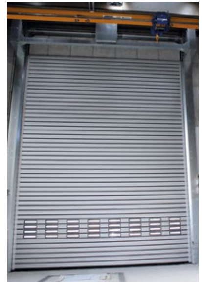
Das etwa 4,3 Tonnen schwere Tor verhindert unter anderem den Zustrom von Kaltluft in die Servicehalle
