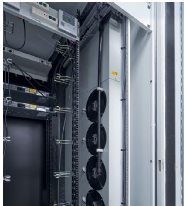
Die Kühlung der Serverschränke erfolgt über das integrierte Split-Klimagerät LCU DX (Liquid Cooling Unit) von Rittal mit Außeneinheiten
