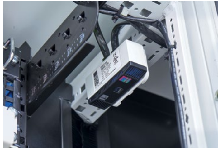
Für die Überwachung des Gesamtsystems setzt B. Braun auf die Monitoring-Lösung CMC von Rittal
