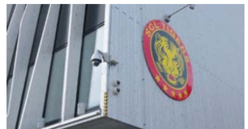
Im Außenbereich des Stadions wird Modell WV-SW598A eingesetzt, eine Full HD IP-Fixkuppel-Kamera mit PTZ-Funktion
