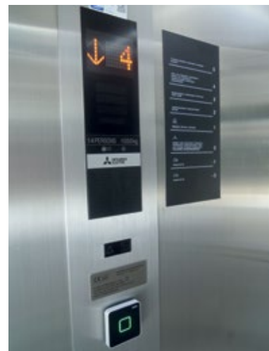
Kaba Exos regelt den Zutritt bei Mitsubishi Electric – und dank diverser Schnittstellen kann das System noch mehr: Zum Beispiel Besucherverwaltung und Raumbelugung
