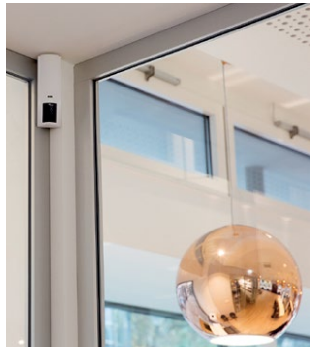
Planung und Installation der Hybrid-Einbruchmeldeanlage Daitem D24 nach VdS-B: Die besondere Raumsituation mit Séparée und Kupferlampen forderten das Know-how der Sicherheitsexperten von „Kommissar Alarmanlagen“
