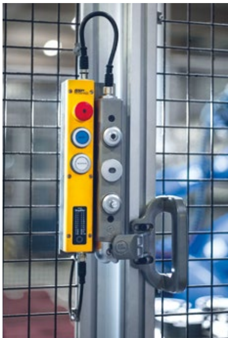
Die Safety Simplifier auf dem Roboter-Schalt-schrank schalten die Roboter ab
