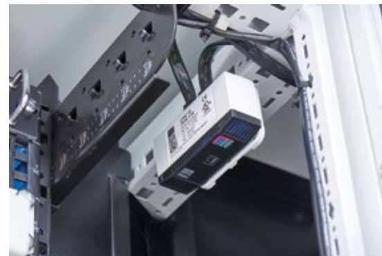
Temperaturüberwachung als Minimalanforderung für effizienten und sicheren IT-Betrieb: über Monitoring-Systeme – wie das modular aufgebaute Computer Multi Control (CMC) III von Rittal – lassen sich IT-Umgebungen effizient überwachen
