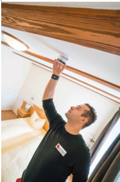
Die Elektroinstallateure von LS Elektrotechnik haben in jedem der Gastzimmer Rauchwarnmelder Genius Plus X installiert
