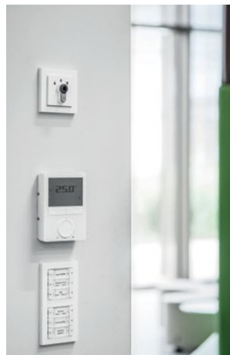
Zur blueSmart Anlage der PMU gehören über 400 elektronische Zylinder, die den Zutritt in die verschiedenen Universitätsbereiche sichern
