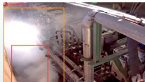
Smoke-Alert-Mode: Alarm ist ausgelöst - in BMA übermittelt
