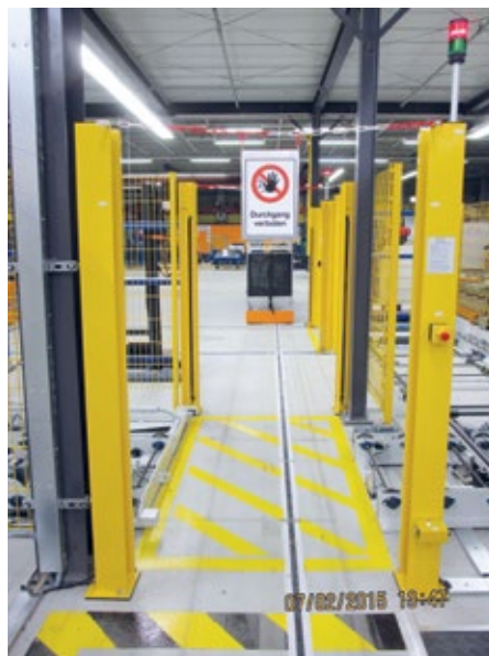
Die Lichtschranken PSENopt von Pilz stellen an der Schleuse, die den fahrerlosen Transportsystemen die Durchfahrt ermöglicht, sicher, dass während der Aufrichtbewegung niemand gefährdet wird
