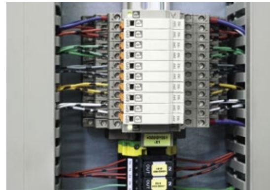
Kompakter Schutz schafft Platz im Schaltschrank: 20 Adern werden auf nur 60 mm geschützt – durch zwei zusätzliche Fernmeldemodule ist die Leitwarte jederzeit über den Zustand der Anlage informiert
