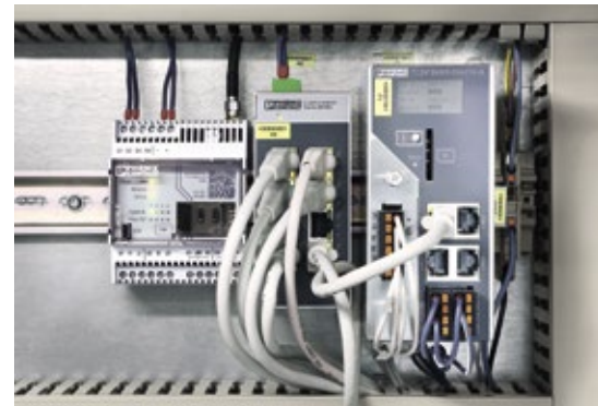
Sichere Datenübertragung per SHDSL: dank integriertem Überspannungsschutz im TC-Extender (rechts)
