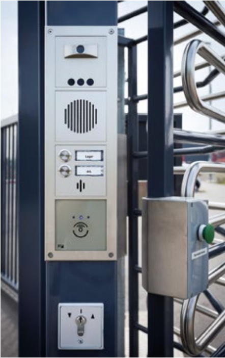
Mit den Transpondern werden die Schranken und Vereinzlungsanlagen an der Zufahrt zum Werksgelände geöffnet. Im Bild: Drehkreuz mit Leser
