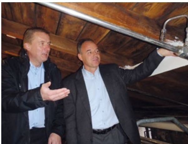
Gerd Heetpas (l.) und Walter Arnold: Selbst im Zwischendeckenbereich des Festsaals sind Sprühköpfe der Feinsprühlöschanlage installiert, um auch dort den Wassereintrag möglichst gering zu halten
