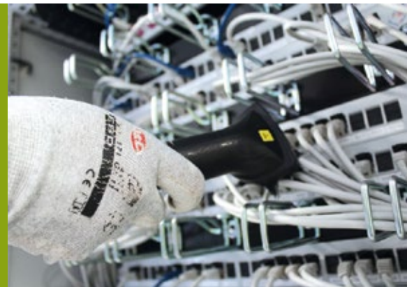
IT-Infrastrukturen in Rechenzentren sind komplex – und erfordern erhöhte Sorgfalt bei Wartung und Reinigung
