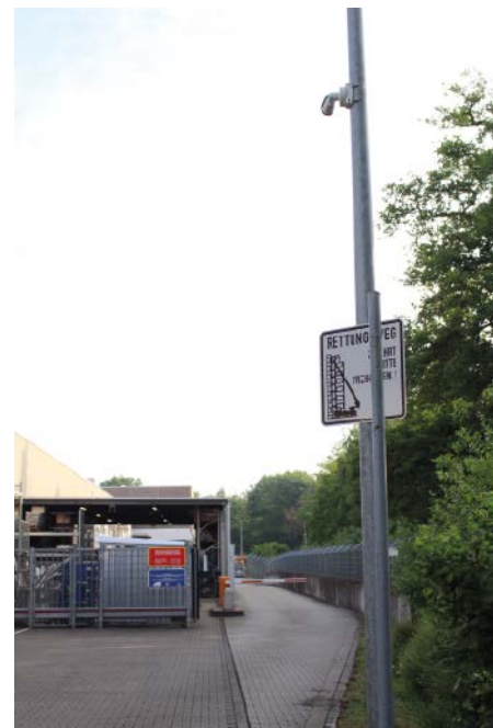
Es wurden 38 Axis-Netzwerk-Kameras, acht C3003-E Network Horn Speaker und zwei A8004-VE Network Video Door Stations für die Zwei-Wege-Kommunikation installiert
