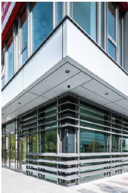
▲ Wo im EG die Rettungswege ins Freie führen, wurde die Ausfahrtiefe der Schüco Großlamellen ALB auf 1,20 m beschränkt, um im Brandfall den Durchgang zu gewährleisten
