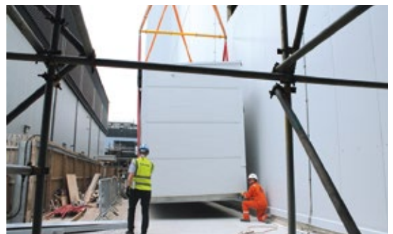
Da der Einsatzort nicht anders zu erreichen war, musste der Container per Kran eingesetzt werden
