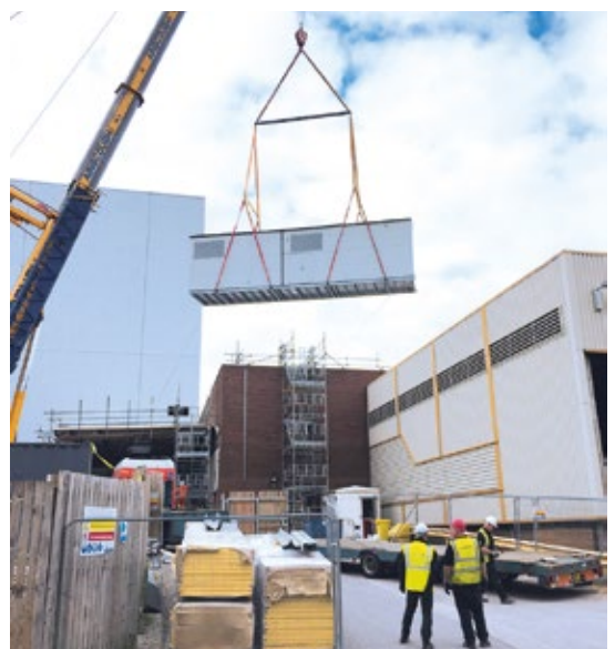
Nachdem der Container über mehrere Gebäude gehoben wurde, landete er sanft am Einsatzort
