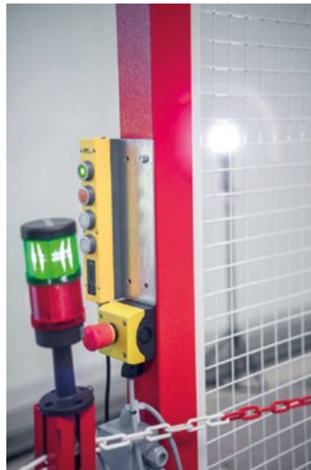
▲ Verbautes Wireless-Gerät an der Abgabe Station mit externem Not-Halt
