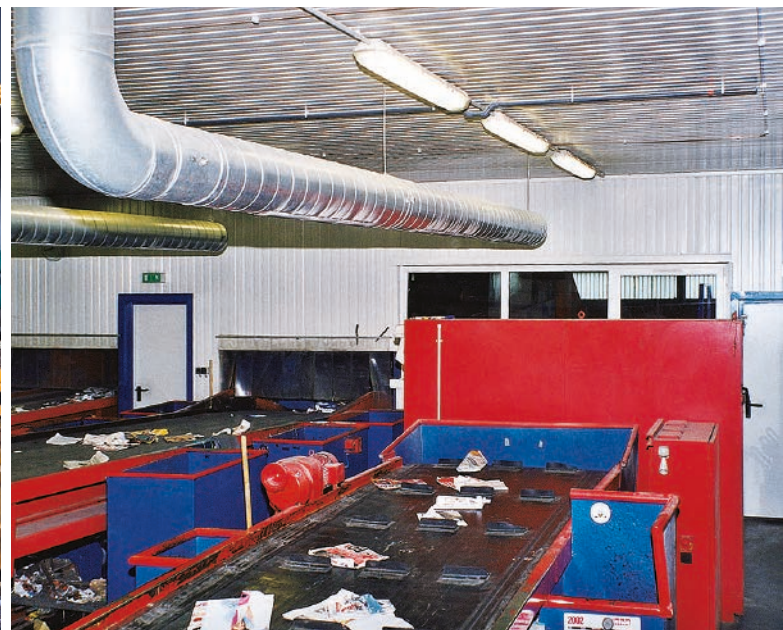
In der Sortieranlage Achern wurden sechs Ansaugrauchmelder mit 500 Meter Ansaugleitung aus PVC installiert
