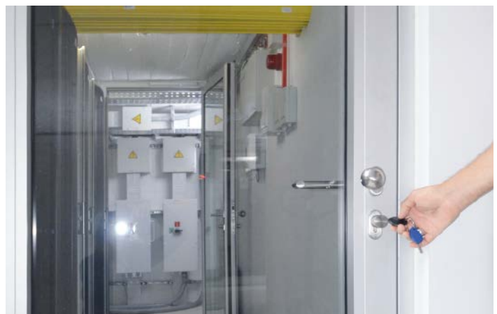
Um das Sicherheitsniveau maximal hoch zu halten, wurde für den Zugang zu den freigegebenen Etagen, in spezifische Serverräume und zu abgeschlossenen Racks eine Dreifach-Authentifizierung zugrunde gelegt
