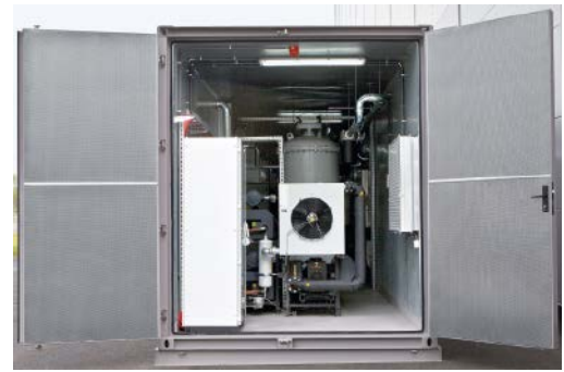
Die gesamte Brandschutztechnik ist platzsparend in einem Container verbaut
