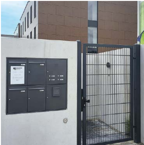
▲ In der Briefkastenanlage ist der Update-Leser integriert. Hält der Mitarbeitende seinen Transponder davor, wird der Kontakt zum Tor freigeschaltet und die Berechtigungen aktualisiert
