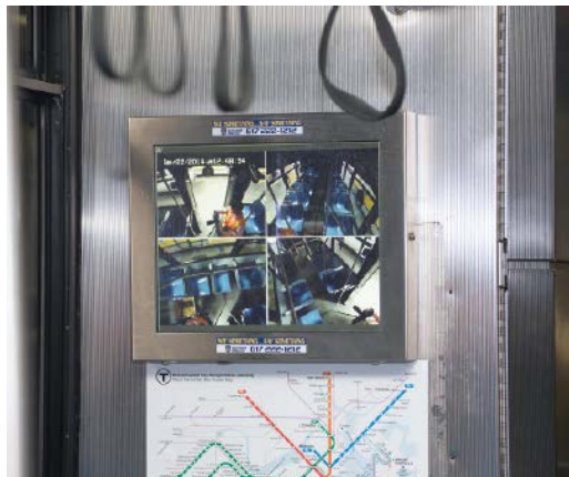
Im Bus installierte Monitore zeigen alle Vorgänge im Bus und sollen potenzielle Straftäter abschrecken
