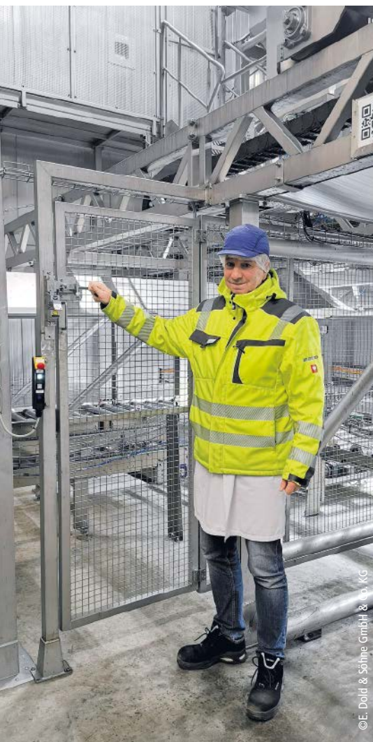
Jörg Schäfer, der mit seinem Team die Installation und Inbetriebnahme der Sicherheitstechnik durchgeführt hat, ist zufrieden: „Das Safemaster STS System arbeitet absolut zuverlässig.“
