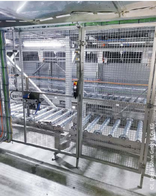
Die Anlagen zur Produktion von Tiefkühlgemüse bei Iglo in Reken sind zu einem großen Teil im gekühlten Bereich installiert
