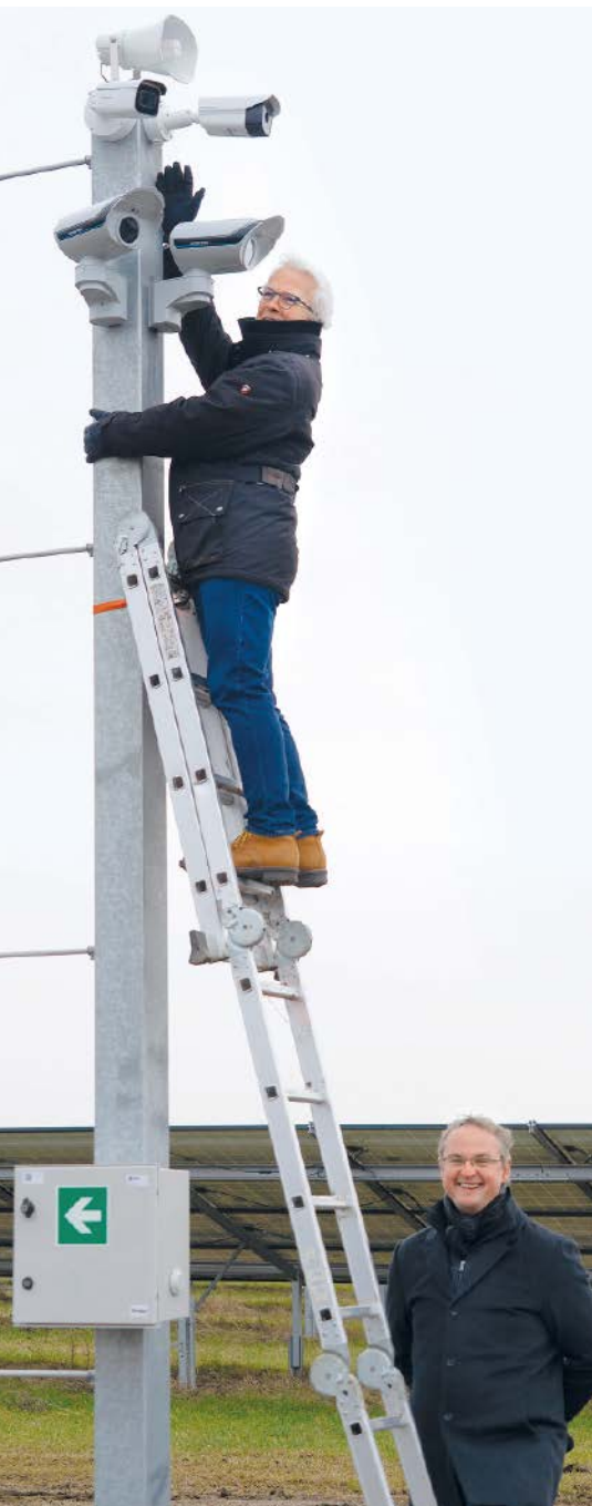
Torsten Ulmer, Honeywell (auf der Leiter) und René Steinkellner, Styx, beim Einmessen des PIR und der Videoanalyse
