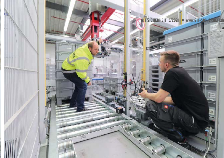
▲ Durchführung einer Nachlaufzeitmessung an einem Portalroboter; dies ist nur eine der Dienstleistungen von Phoenix Contact für die Sicherheit der Industrie
