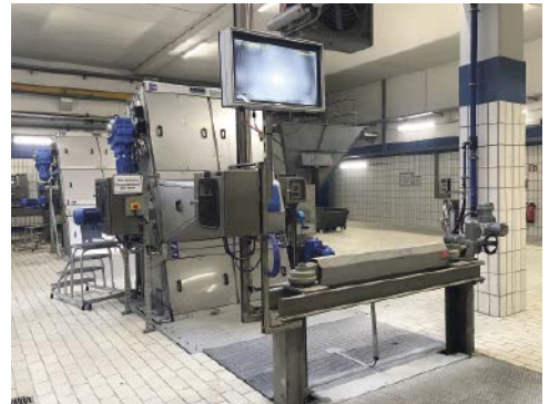
Da die Rechenanlage im Klärwerk ein abgeschlossenes System ist, kann man vor Ort nicht einfach in die Rechen schauen – Abhilfe schaffen geeignete Monitor
