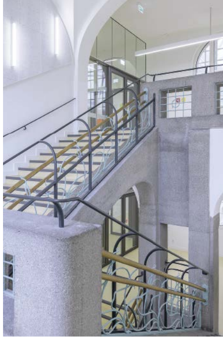
Die Brandschutztüren im freien Glasumfeld verleihen der Architektur ein filigranes leichtes Erscheinungsbild
