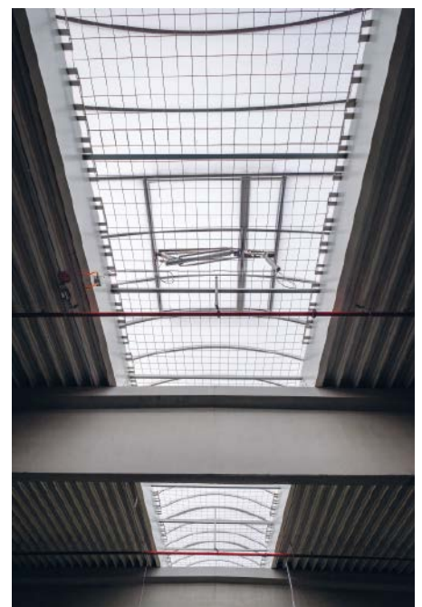
Absturzsicherungen und Auffangeinrichtungen bleiben in der Regel dauerhaft installiert und bieten damit dauerhaften Schutz
