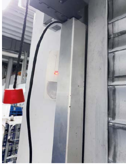
Oftmals wird es dem Täter aber auch sehr leicht gemacht, einen Bewegungsmelder zu umgehen. Bei diesem Melder wird ein Großteil des Überwachungsbereiches durch die seitliche Führungsschiene des Rollltores verdeckt
