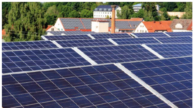
Schon seit 2009 ist auf den Dachflächen eine Photovoltaikanlage installiert
