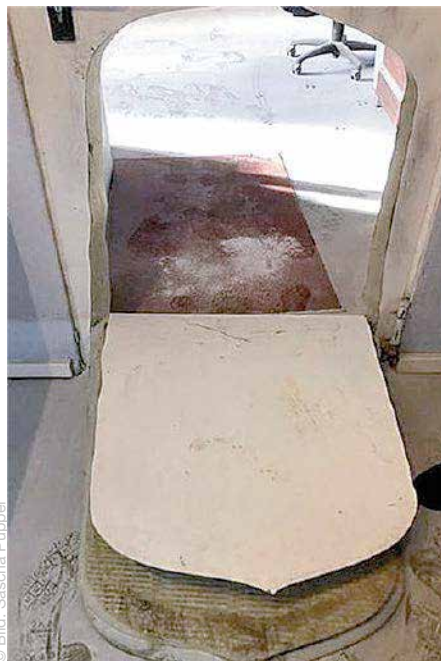
Öffnungsüberwachung einer Stahlblechtür: Überwindung durch Schneiden einer durchstiegsfähigen Öffnung
