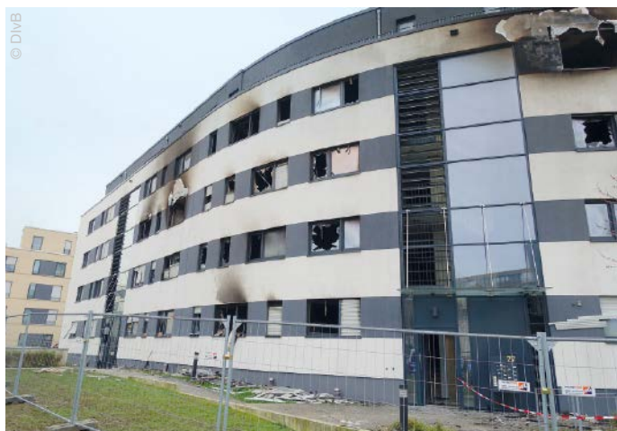
Der Essener Gebäudekomplex nach dem Großbrand
