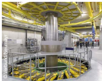
Kraftwerk Limberg II
