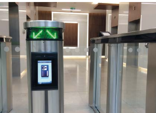
Das smarte Aufzugssystem beim One Albert Quay wird zentral über die AC2000-Zugriffskontrolle und emerald-Terminals gesteuert
