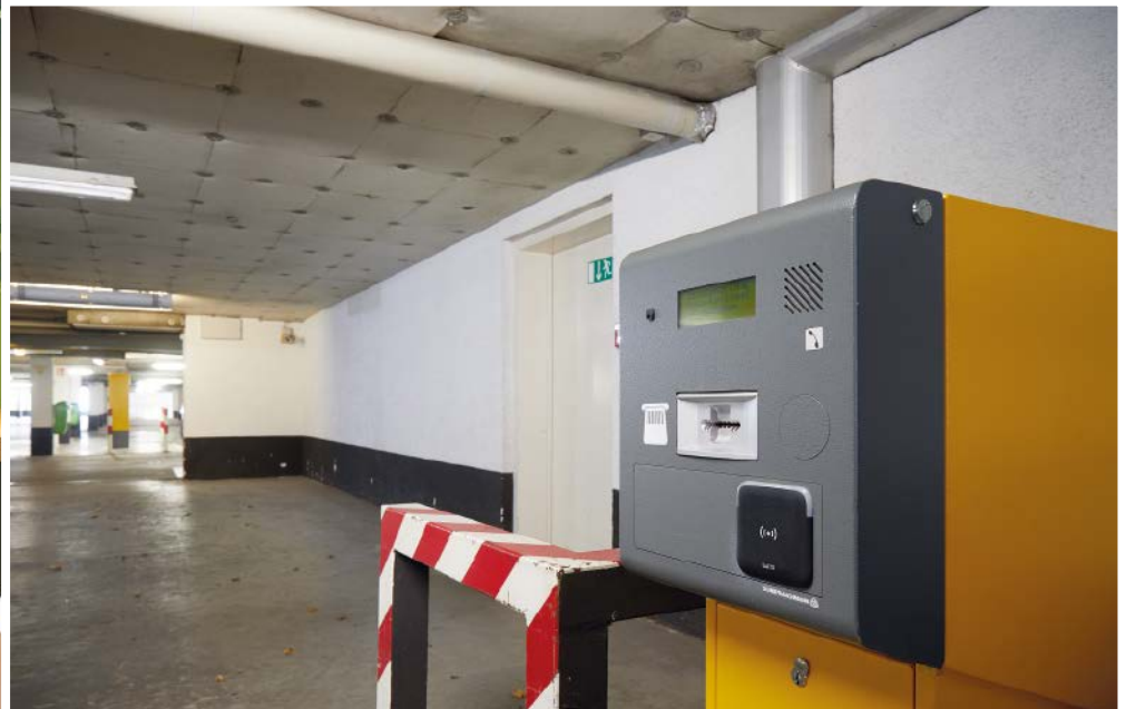
Über verkabelte Wandler werden häufig Drittsysteme wie Schranken oder automatische Türsysteme angesteuert
