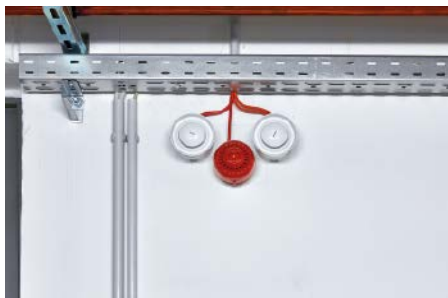
▲ Von der Brandmelderzentrale führen Signalleitungen zu internen optischen und akustischen Alarmgebern
