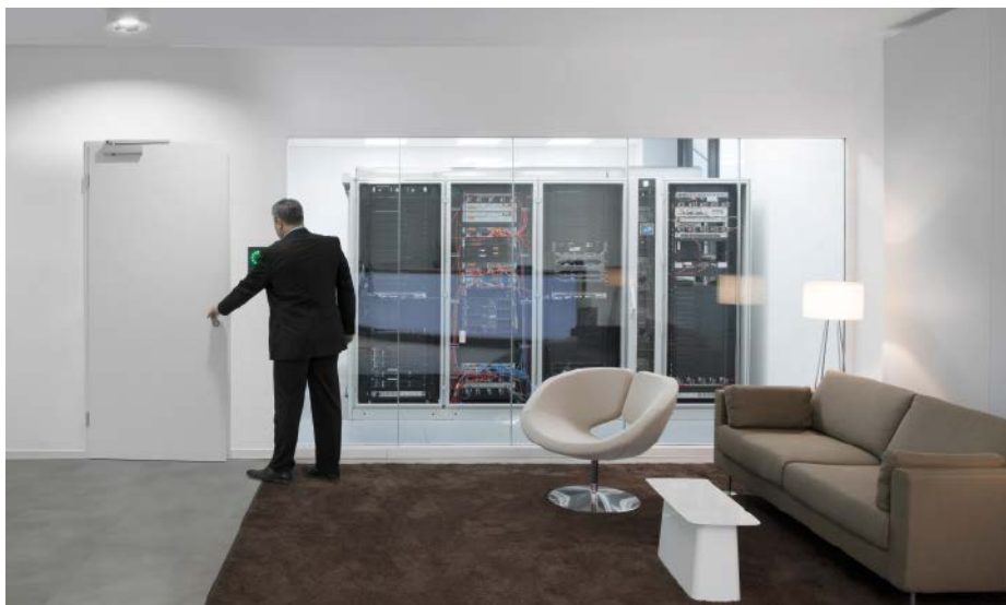
Schutzsystem für Bankfilialen: Der Kundenkontakt soll möglichst wenig beeinträchtigt werden – und in Hochrisikobereichen bewährt sich eine Vereinzelungsschleuse mit biometrischer Zutrittskontrolle
