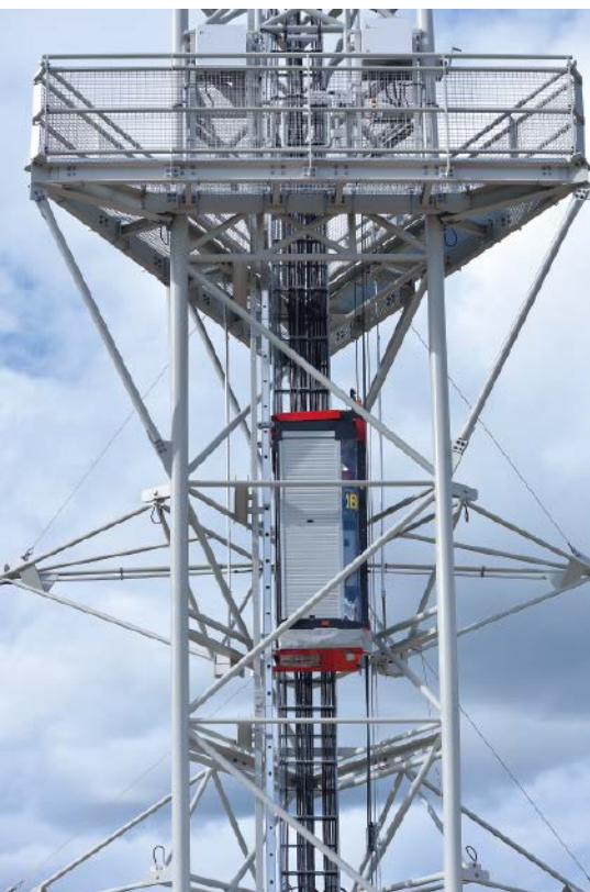
Für Projekte wie Brücken, Schornsteine, Kraftwerke, Talsperren – oder wie hier an einem Wettermast – wird die Arbeit der Monteure durch den Einsatz der Lifte sicherer, komfortabler und gesundheitsschonender
