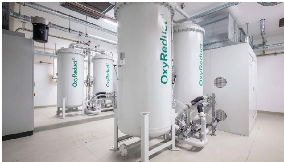
Das Sauerstoffreduzierungssystem Oxyreduct erzeugt für die aktive Brandvermeidung Stickstoff aus der Umgebungsluft. Wie stark das Sauerstoffniveau im Schutzbereich mit dem Inertgas abgesenkt werden muss, hängt von den dort gelagerten kritischen Materialien ab
