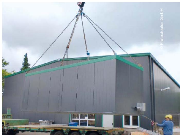
Außenaufstellung eines Brandschutzcontainers F90 beim Kunden
