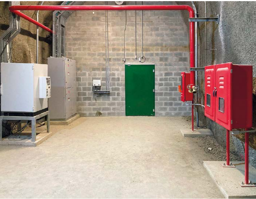
Fertig installierte Dali-Boxen an der hinteren Wand im Technikraum – platzsparend, schnell installiert und einfach an das bestehende Netzwerk angebunden
