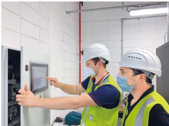
Über die Bedienpanels in den Schaltschränken lassen sich die ATS-4-Master und ATS-4-Dali-Masterschränke einfach parametrieren – ohne Programmieraufwand
