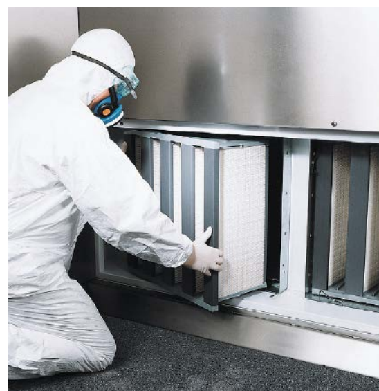
In der LAF Kabine werden effektive Schwebstofffilter eingesetzt
